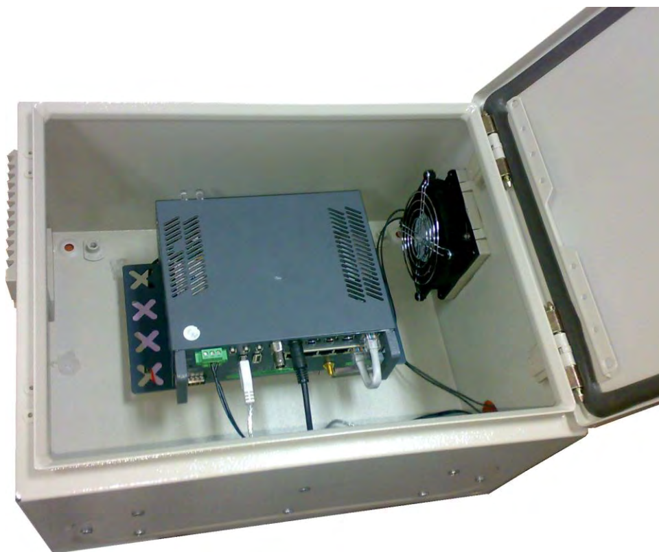
Рис. 1: Видеошлюз, установленный в изолированный контейнер
